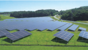
明和町斎宮きららの森太陽光発電所
